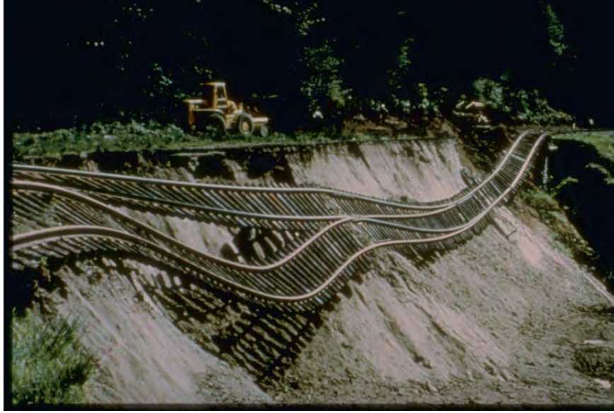
Figura 37: Deslizamiento de un talud y efecto sobre la línea férrea.
